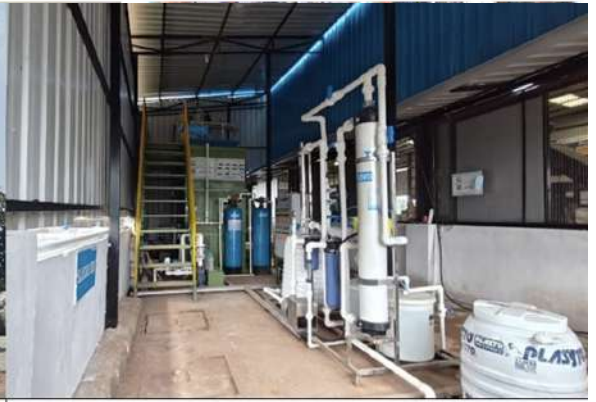
Effluent Treatment Plant (ETP)
