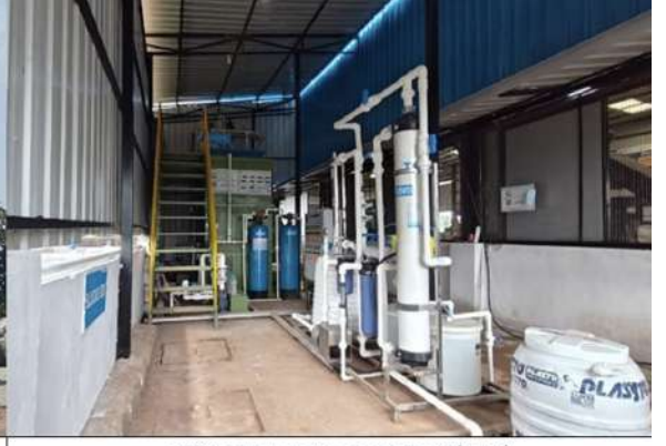
Effluent Treatment Plant (ETP)
